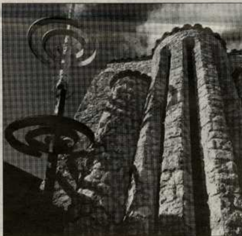
L'opera di Karl-Heinz Steck danneggiata dal crollo; in alto: i resti della copertura che ha ceduto
